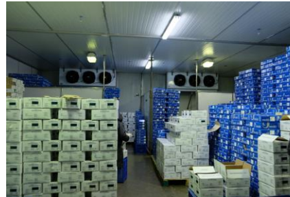
CHILL ROOM DIVISI PASTEURISASI
