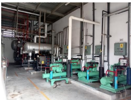
RUANG MESIN & COMPRESSOR
